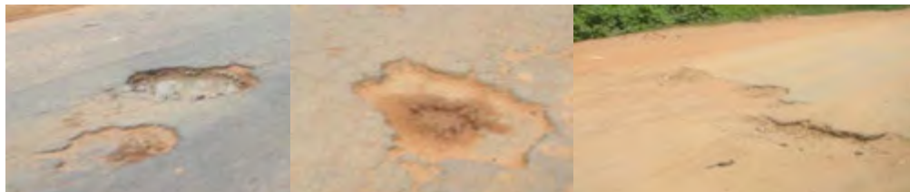
Figure 4.1 Nids de poule et imperfections de la chaussée
