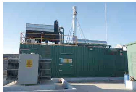
Foto: Planta eléctrica a biogás
