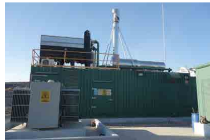
写真 バイオガス発電施設
