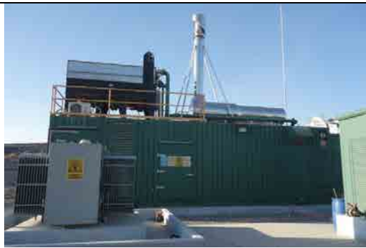
ケタロ州メタンガス回収発電施設
