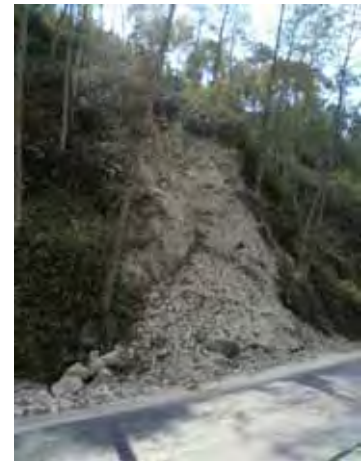
写真 6-2 道路斜面の小崩壊 雨期には多発して交通傷害を起こす
