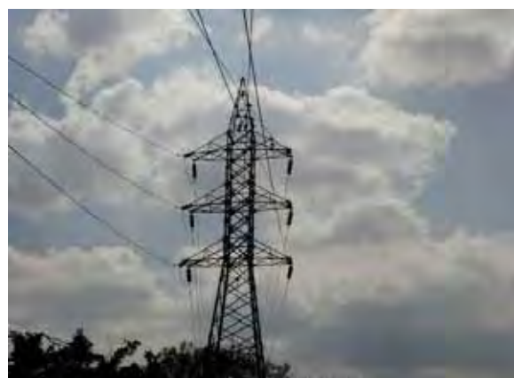
写真 6－10 カトマンズ市内の66kV送電線
