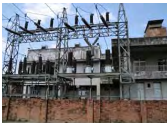
写真 6－9 カトマンズ市内Teku変電所
