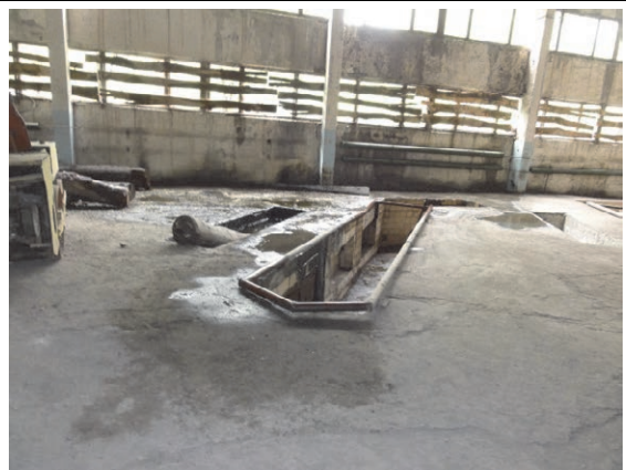
PLUAD 3 (ナリン州) DEP 8 ワークショップ 整備ピット有り
