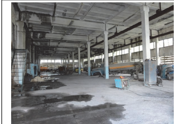
PLUAD 3 (ナリン州) DEP 8 ワークショップ 照明・電源設備、窓の改修が必要
