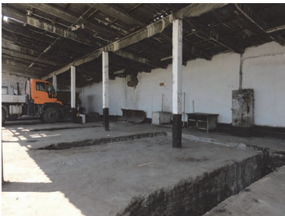
OSI UAD (ジャララバード州) DEP 45 ワークショップ建屋 整備ピット有り
