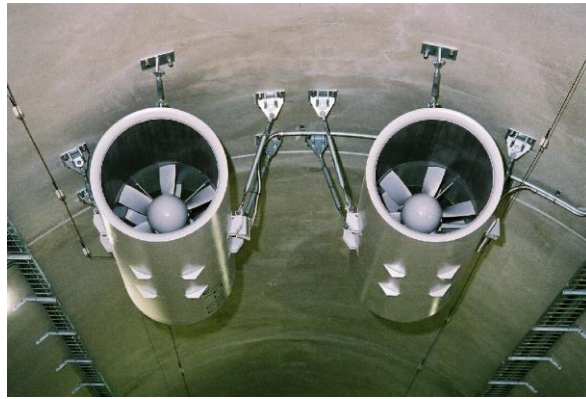
トンネル内のジェットファン
