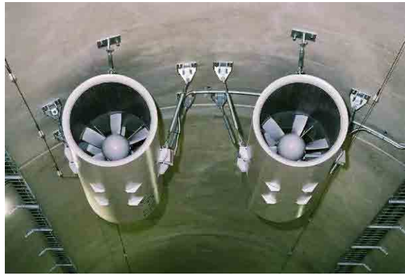
トンネル内のジェットファン
