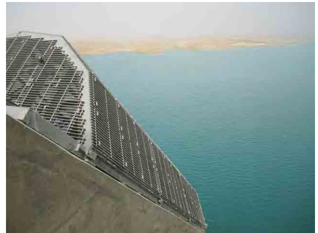
南部ジャジーラ灌漑事業取水施設の 塵除けスクリーン
