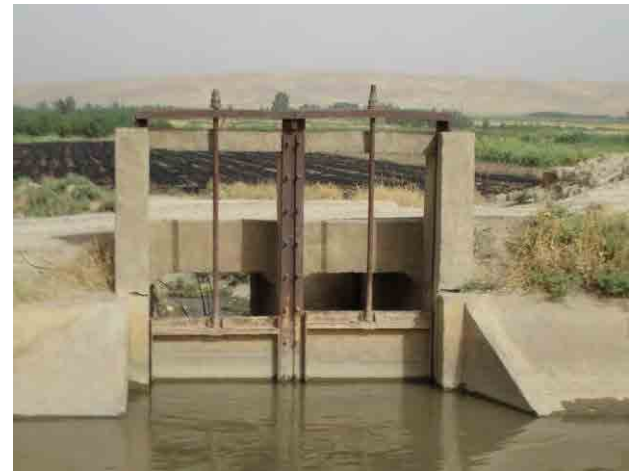
クルド地区内の灌漑用水路における取水堰
