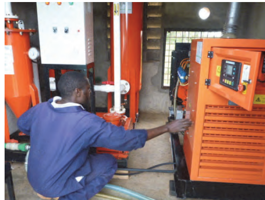
Photo: Biogas Generator (20 kVA)
