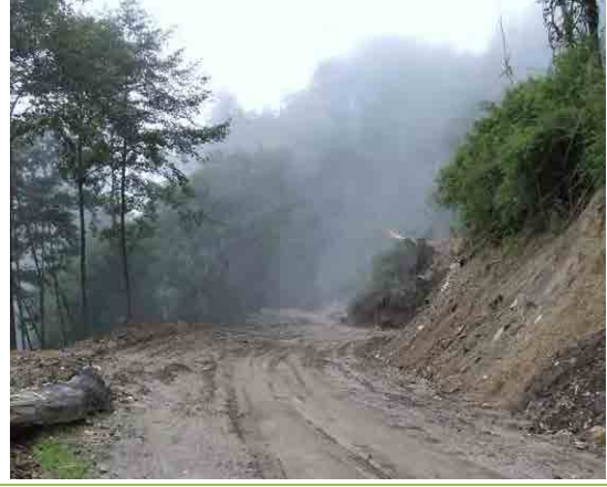
ガザ BHU へ通じる山岳道路。雨で道路は泥濘、崖崩れで道幅が車 1 台通行可能な状態。ブータン国の山道はどこも同じような道路環境にある。
