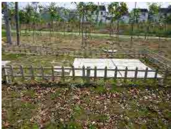
①A20 法による工場生産型浄化施設全景 水路を隔てて隣接する住宅地（他の浄化施設が設置されている）
