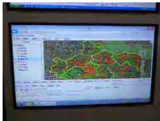
⑤周行下水処理場： 中央監視室 処理区域内の管路施設表示
