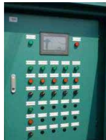
①A20 法による工場生産型浄化施設 制御盤 異常があれば中央監視装置に通報
