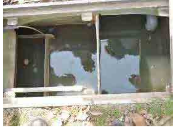
①A20 法による工場生産型浄化施設 終沈部分 製造会社により設置後 1 年間は、維持管理が行われるが処理水質は良好ではない
