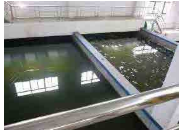
⑤周行下水処理場（嫌気・好気ろ床法） 嫌気性ろ床部分
