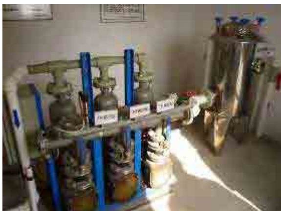
③ トイレ排水の化糞池処理 真空ポンプユニット(中国製)
