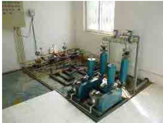
② MBRによる現場打ち浄化施設 反応槽内に設置された膜を通して処理水を 吸引するためのポンプ
