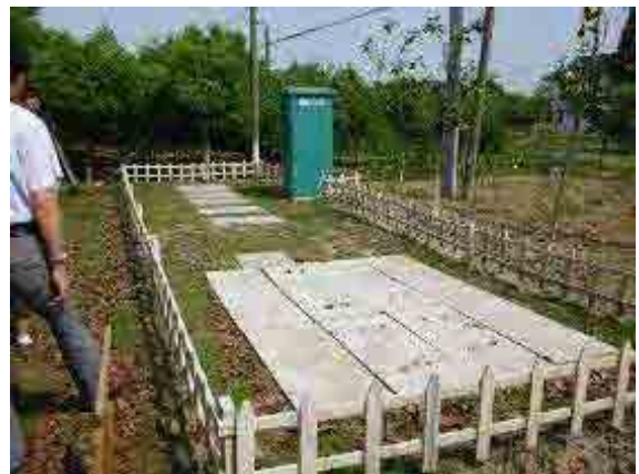
①A20 法による工場生産型浄化施設 [50 世帯 (10m 3 /日)] 手前は、流量調整池。奥側が、反応槽・終沈、緑色のボックスは制御盤
