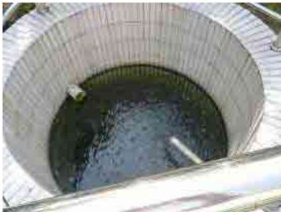
② MBRによる現場打ち浄化施設 膜による処理のため、処理水質は良好
