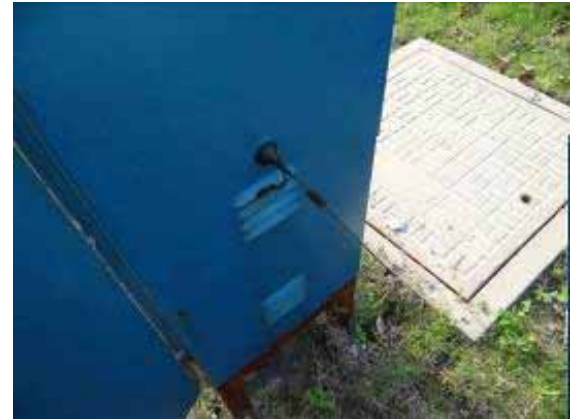
④ SBRによる工場生産型浄化施設 機器の異常を中央監視室に知らせるための 発信機アンテナ
