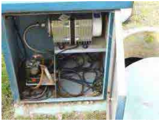
④ SBRによる工場生産型浄化施設 コンプレッサー
