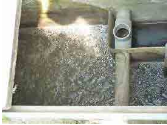
①A20 法による工場生産型浄化施設 反応槽部分（好気槽部分）MLSSが低い
