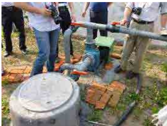
③ トイレ排水の化糞池処理 1,000人規模の化糞槽(実際は23世帯)化糞池メ タン収集部分
