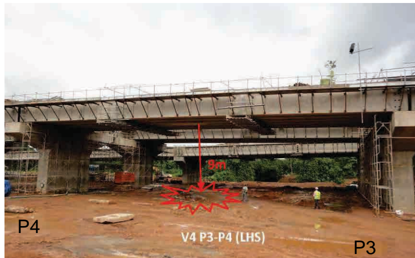
写真 4.4.3 事故現場全景：本線東側より本線方向を望む
