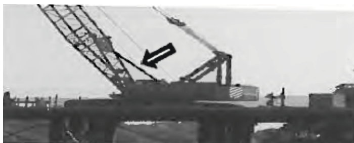
写真 4.4.1 ストッパーが欠落しているとされる写真
