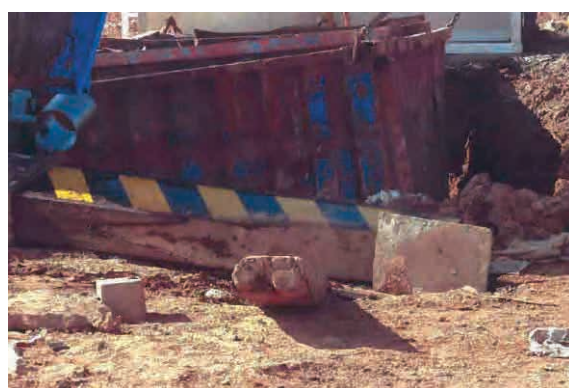
沈下したアウトリガーの状況
