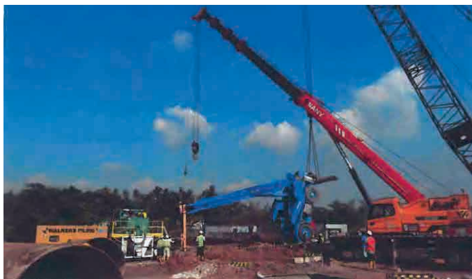
転倒状況（復旧作業のためクローラークレーンで支得られている状況）
