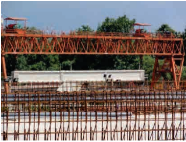
桁製作ヤードガントリークレーン
