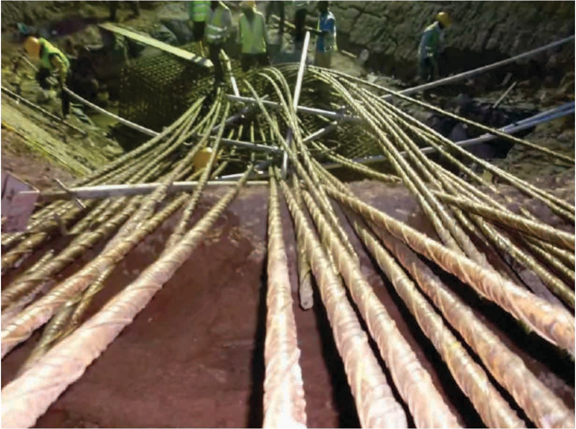
写真 4.4.7 鉄筋かご倒壊状況
