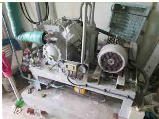
写真-4: マリゴット漁港内の冷蔵庫用冷却設備 (老朽化)
