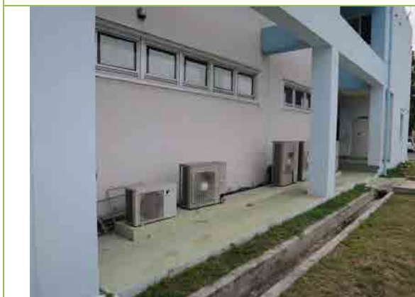
写真-3： ポイントワーフ水産センターの空調機(写真は室外機、スペアパーツが調達不能)
