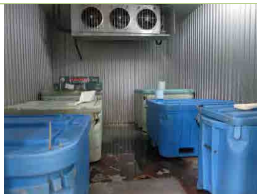
写真-2： マーケットワーフ水産コンプレックス内の既存冷蔵庫（故障中、氷の保管庫として代用）
