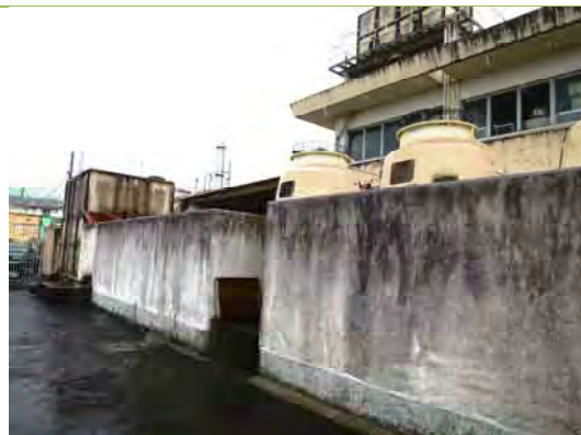
写真-2: ロゾー水産コンプレックスの水冷コンデンサー (4基) (老朽化、1基は完全に使用不能)
