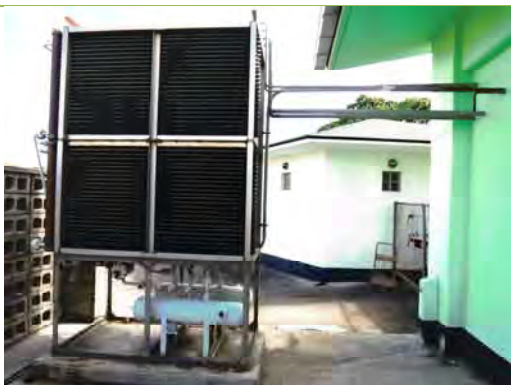
写真-1： バセテール水産コンプレックスの空冷コンデンサー（老朽化により熱交換性能が低下）
