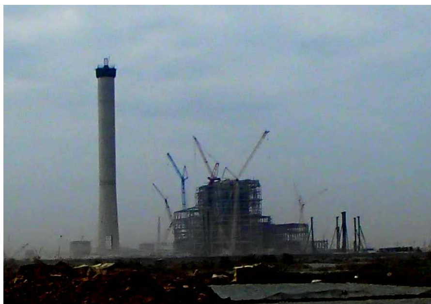
写真 2.4.1 建設中のズーエンハイ石炭火力発電所 (2014 年 3 月 : 調査団撮影)
