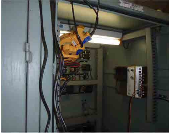
Majuro5 号機 電力量計 電流クランプ ® 設置 (持ち込み計測器)
