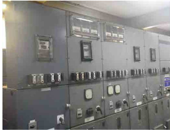
Majuro1~5 号機 電力量計盤
