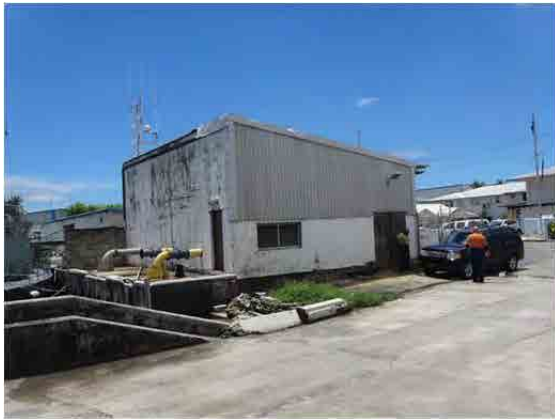
Majuro1,2号機 冷却水取水ポンプ建屋
