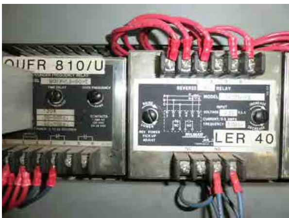
不足/過周波数継電器・逆無効電力継電器
