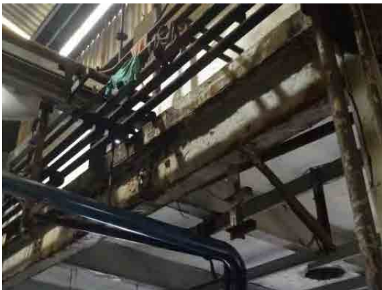
Majuro 発電所 No.1 鉄骨腐食状況
