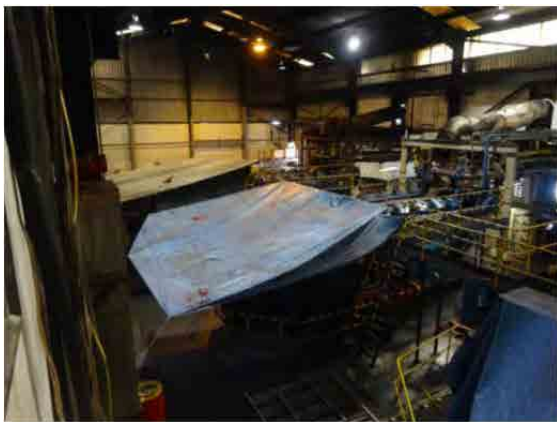
Majuro 発電所 No.1 1号機、2号機 (雨漏りによる雨よけのブルーシート)
