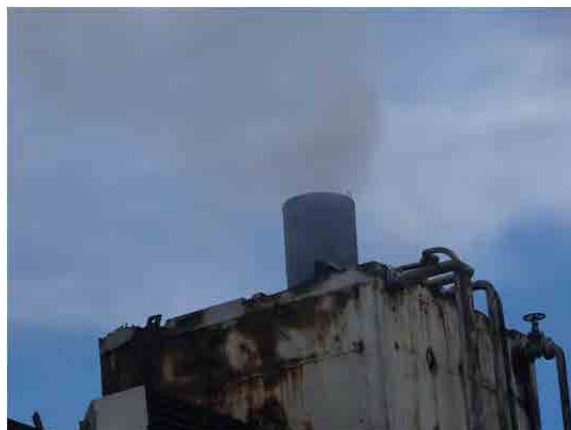
図 3.4.4-2 Majuro 発電所 1号機 煙突(黒煙噴出)
