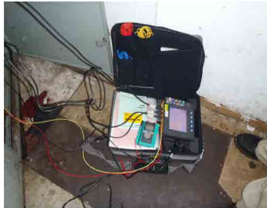
Majuro2 号機 電力量計設置 (持ち込み計測器)
