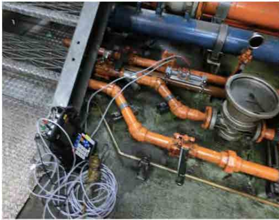
Majuro6 号機 燃料流量計設置 (持ち込み計測器)
