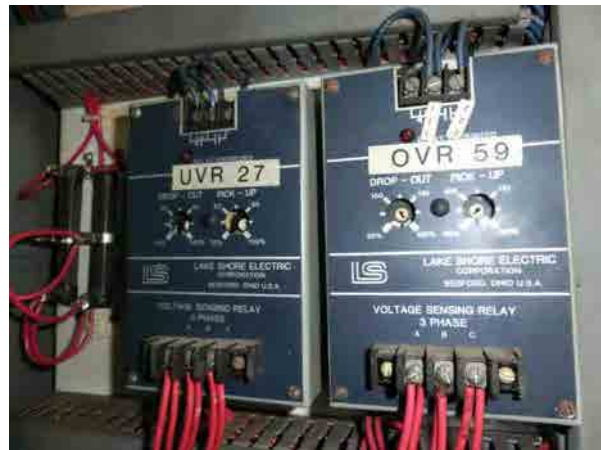
不足/過電圧継電器
