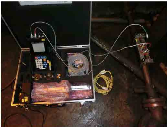
Majuro5 号機 燃料流量計設置 (持ち込み計測器)
