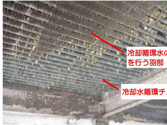
Majuro5号機 ラジエータ (下部拡大撮影)
