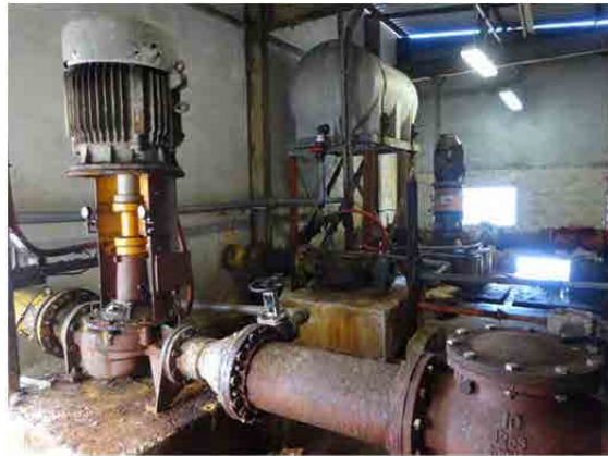
Majuro1,2号機 冷却水取水ポンプ
