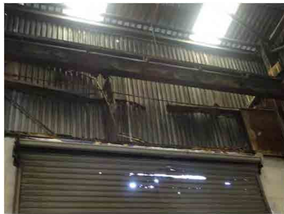
Majuro 発電所 No.1 鉄骨腐食状況
