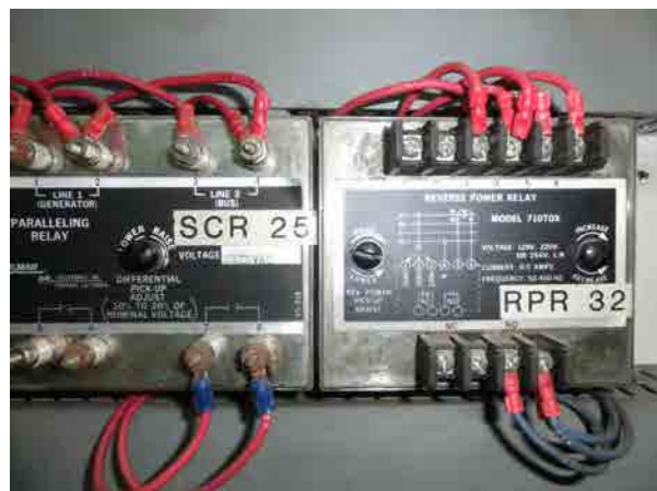
並列継電器・逆電力継電器
