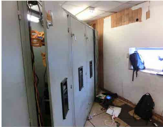
Majuro5 号機 電力量計設置 (持ち込み計測器)
