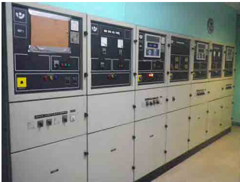
発電機制御盤
