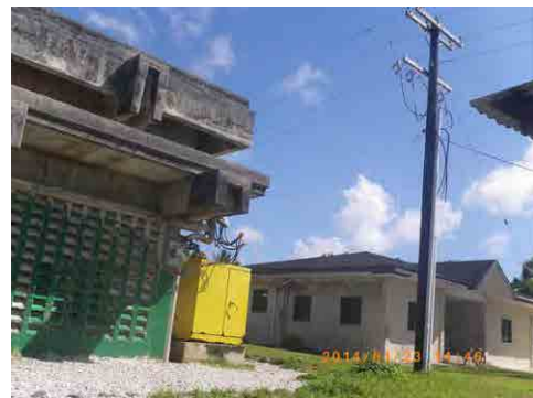
配電線および需要家引込み用 Tr ボックス
