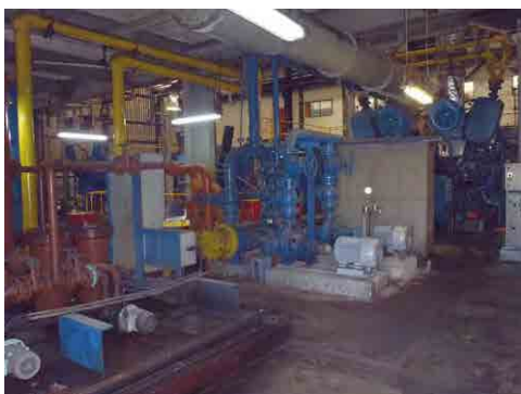
Majuro 発電所 No.2 機関室 補機
