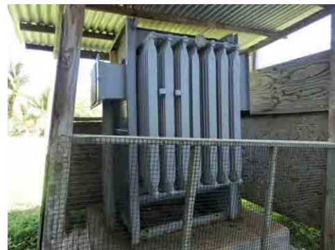
フィーダー昇圧変圧器(4,160/480V)
