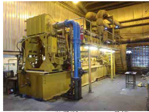
Majuro 発電所 No.1 5号機
