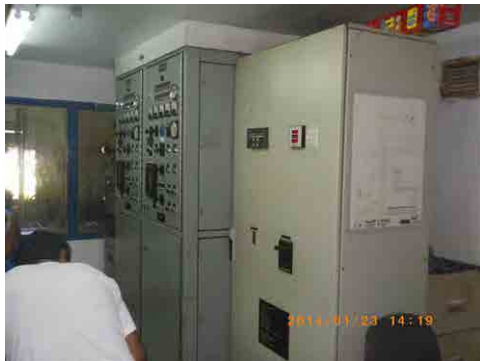
発電機制御盤
