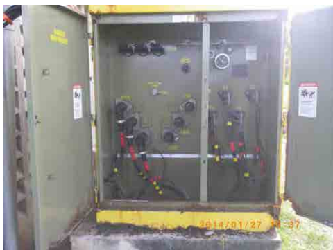
需要家変圧器盤
