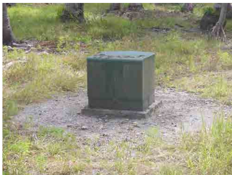
配電線トランスボックス
