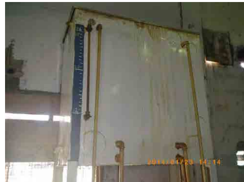
1、2号機サービスタンク
