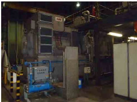
Majuro 発電所 No.2 6号機
