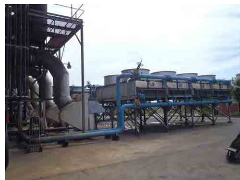
Majuro 発電所 No.2 機関冷却ラジエター
