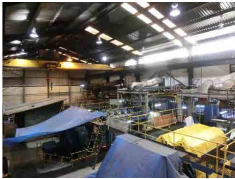
Majuro 発電所 No.1 2,3,4号機
