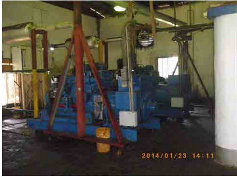
発電機 1号機および2号機
