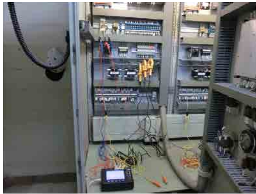
Wotje 発電所負荷遮断試験 計測器設置
