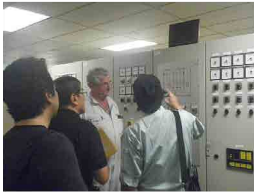
C/P との設備確認調査
