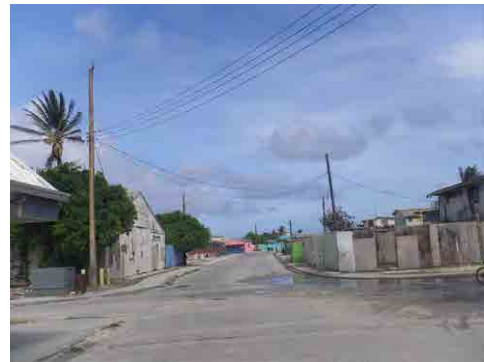
架空配電線(需要家引込)
