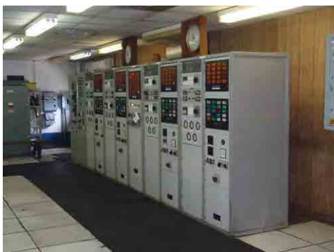
Majuro 発電所 No.1_中央操作室 発電機制御盤
