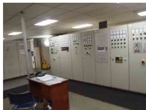
Majuro 発電所 No.2 中央操作室 発電機制御盤および系統監視盤
