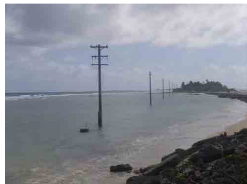
架空配電線(13.8kV)
