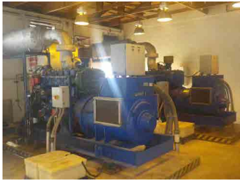
発電機 1号機、2号機
