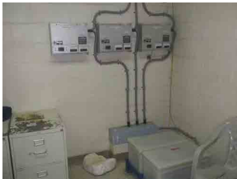
発電機起動用BT、BT充電器
