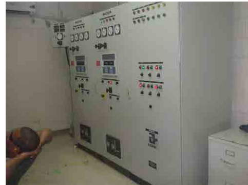
発電機制御盤
