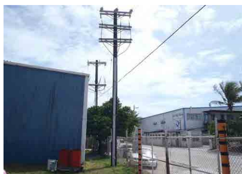
発電所 フィーダー引出柱
