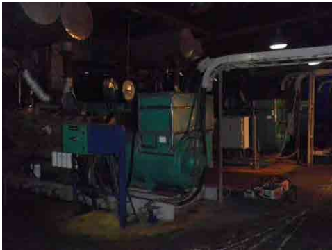
発電機 2号機、3号機
