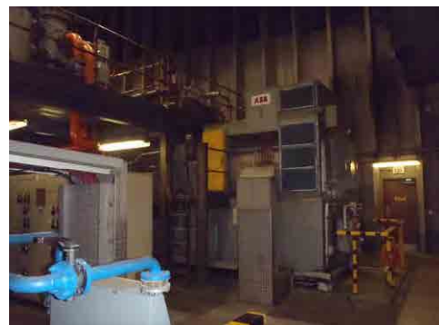
Majuro 発電所 No.2 7号機
