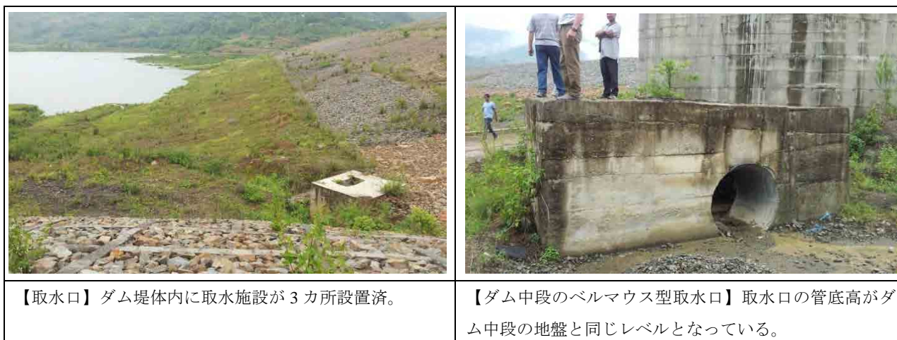
写真 5.2 取水施設（取水口）
