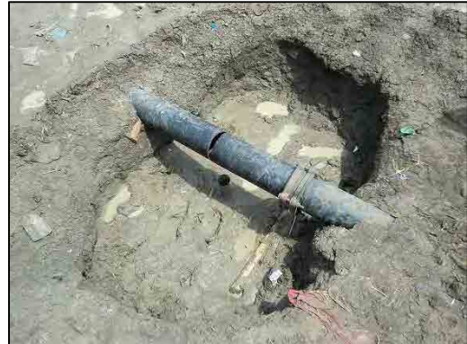
水道管の劣化・損傷による漏水 (高い無収水比率の原因)
