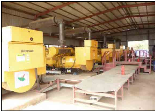
マラカル発電所 (ディーゼルエンジン発電機)
