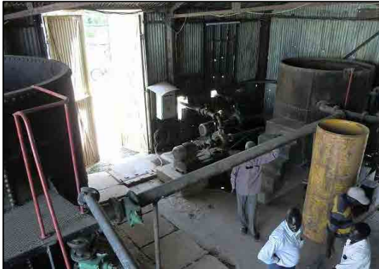
SSUWC 水処理施設内部 (濾過タンク)
