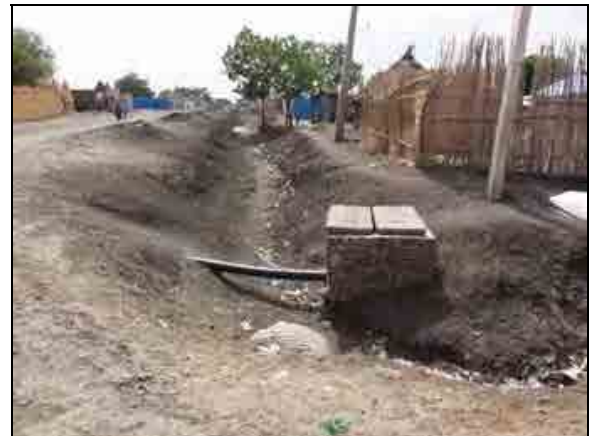
写真 マラカル・タウンの主要排水溝
