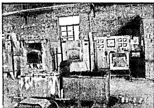
図Ⅲ-3-2-2 電気炉
