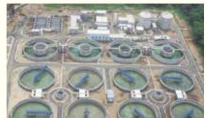
L'usine de traitement des eaux usées
