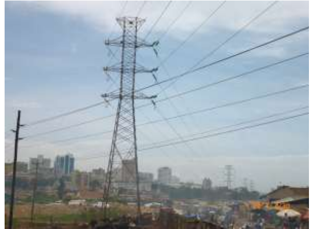
本計画による 132 kV 送電線分岐箇所
