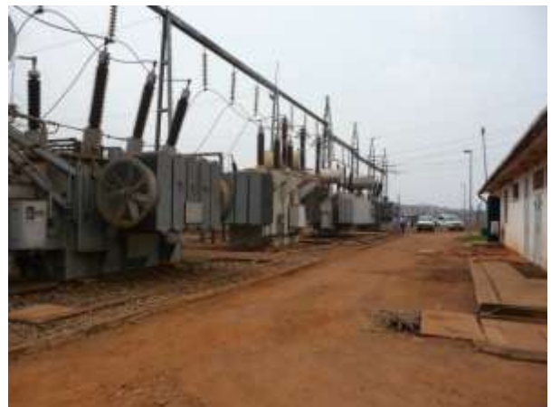
132/33 kV のムトゥンドウエ変電所(変電容量:120 MVA)
