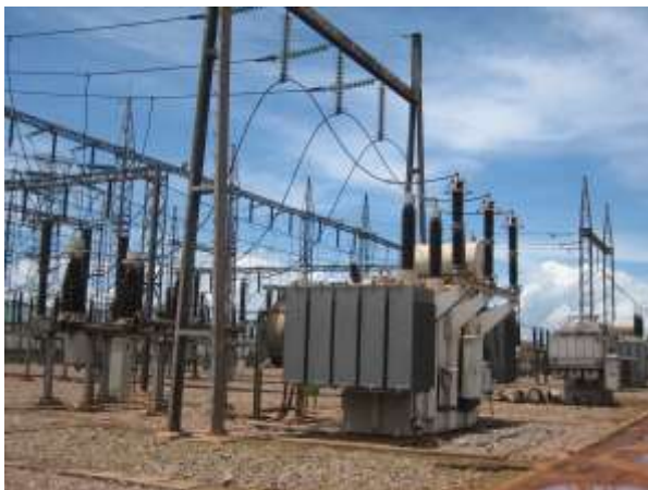
132/33 kV のルゴゴ変電所(変電容量:160 MVA)
