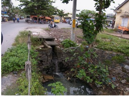
写真-1：新興住宅地からの汚水の流入 住宅街からの生活排水が日本橋水路に流入している
