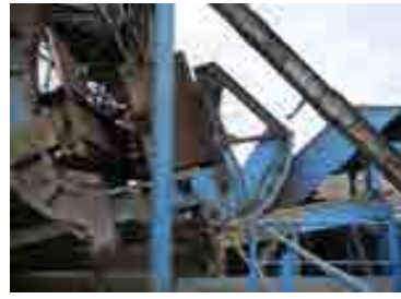
写真 72 荷下ろし設備 (その 2)
