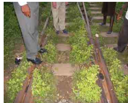
写真 10 脱線の痕跡 (Dunkwa 駅構内)
