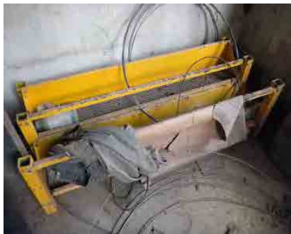
写真 17 閉そく装置のバッテリー跡
