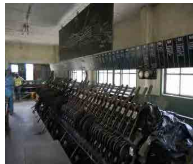
写真 44 Tarkwa 駅構内の機械式 転轍機
