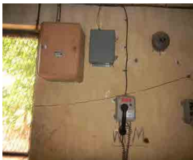
写真 21 旧通信装置 (その 1)
