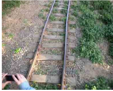
写真 61 極端に状態の悪い線路 (その 1)
