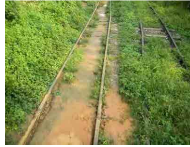
写真 62 極端に状態の悪い線路 (その 2)
