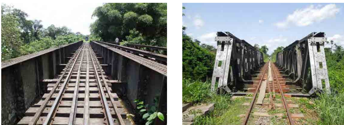
(b) 鋼製下路プレートガーダー橋梁および鋼製下路トラスガーダー橋梁
