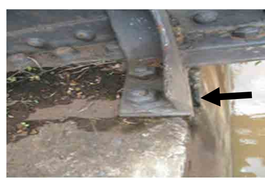
(d) 桁座前面のコンクリートの剥落 (橋梁 No.1)
