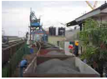
写真 71 荷下ろし設備 (その 1)
