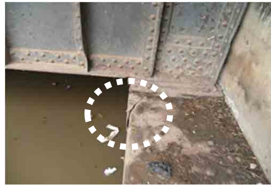
(b) 縁端距離の不足による圧壊 (橋梁 No.1)
