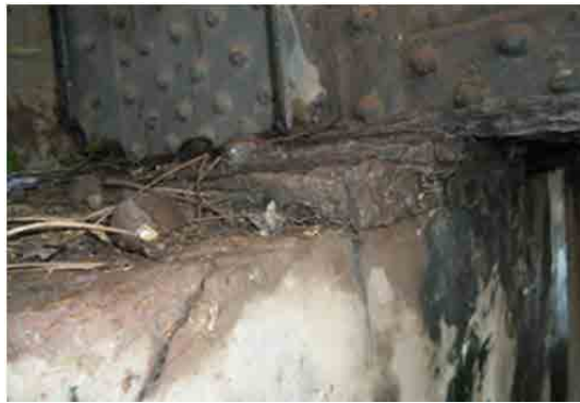
(a) 縁端距離が確保されていない桁座 (橋梁 No.1)
