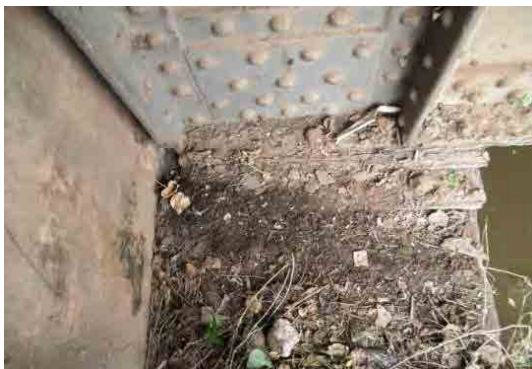
(c) 支承周辺に堆積した土砂 (橋梁 No.1)
