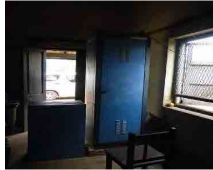
写真 16 閉そく制御器
