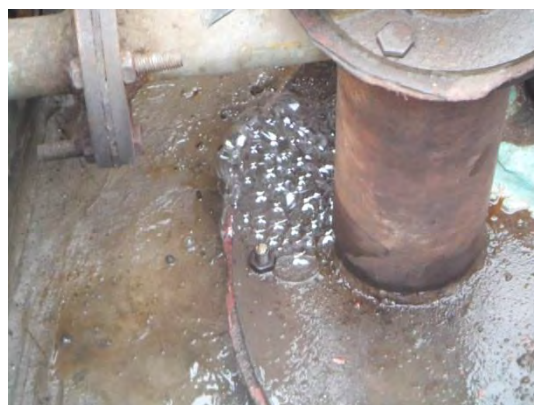
PJT1：マンホールからのガス漏洩
