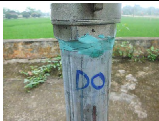
PJT1：通気管ネジからの漏洩
