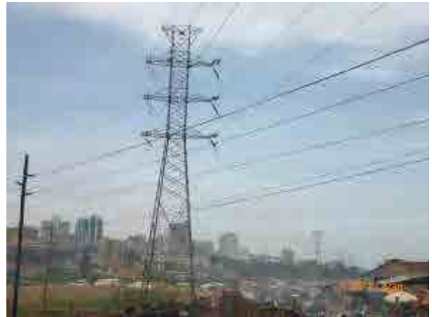
本計画による 132 kV 送電線分岐箇所
