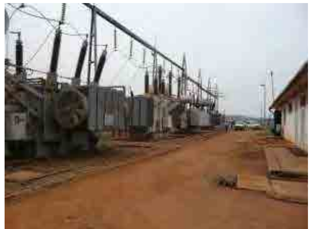
132/33 kV のムトウンドウエ変電所(変電容量:120 MVA)
