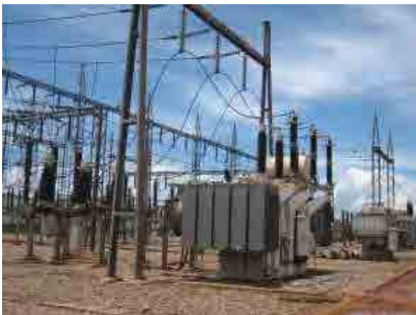
132/33 kV のルゴゴ変電所(変電容量:160 MVA)
