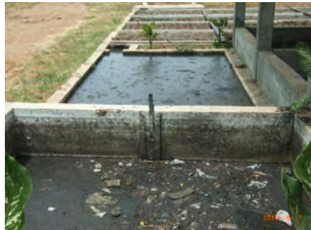
同じ敷地内のし尿処理プラント（手前に投入、処理、汚泥分離後、放流）
