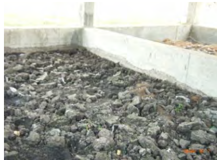
し尿処理施設の汚泥乾燥床
