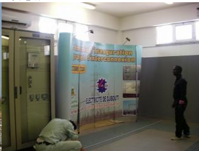
63 kV 保護継電器盤設置予定スペース
