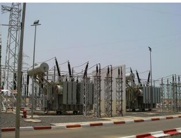
既設 230/63 kV 変圧器
