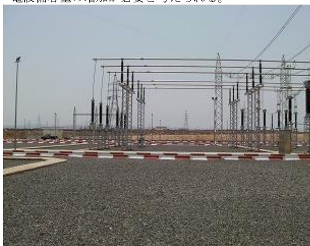
屋外 230 kV 機器及びスペース
