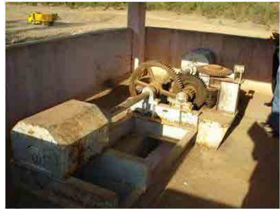
土砂吐きゲート巻き上げ部
