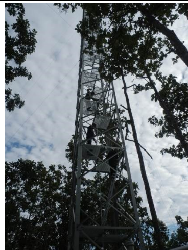
パヤオ大学内にプロジェクトが建設した フラックス観測塔（2）
