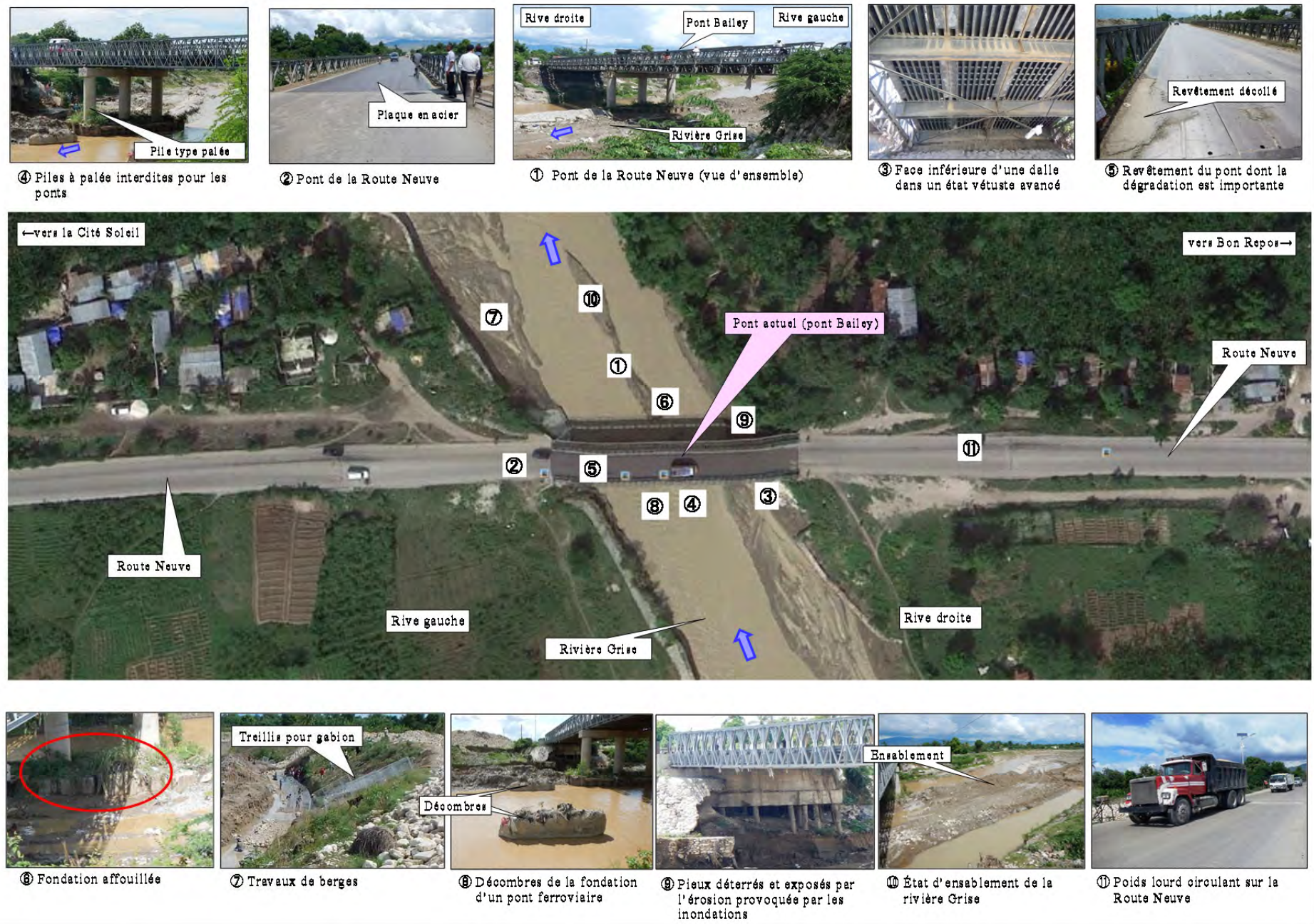
Figure 2-2-9 Carte des résultats de l'étude sur l'état des lieux (Pont de la Route Neuve)
