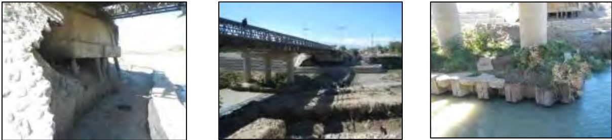
写真 2-2-4 架橋地点の被災状況（新線橋梁）
