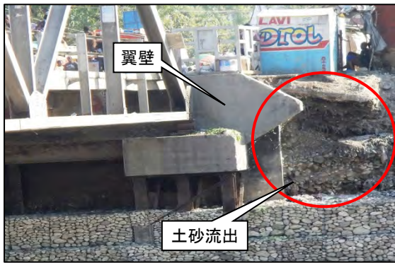
写真 - 5 : 洪水により流出した翼壁部の裏込め土砂
