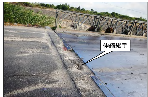
写真 - 20 : 損傷の著しい伸縮継手
