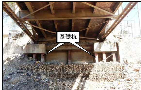
写真 - 6 : 洪水による浸食で露出した基礎杭 (A2)
