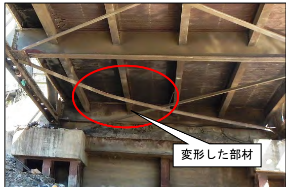
写真 - 8 : 洪水により変形した下横構
