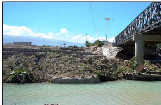
写真 - 28 : 洪水により浸食された堤防
