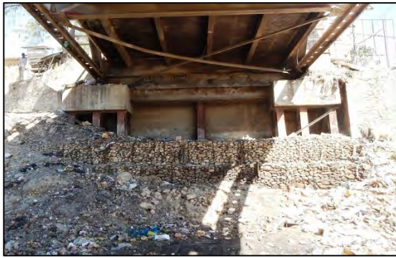
写真 - 9 : 洪水により浸食された護岸
