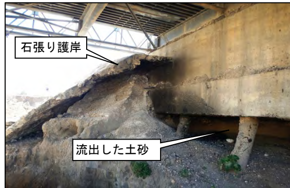
写真 - 26 : 洪水により損害を受けた護岸 (A1)
