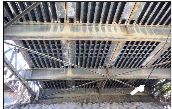
写真 - 22 : 劣化の著しい床版下面
