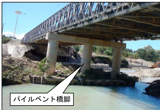
写真 - 23 : 使用禁止のパイルベント橋脚
