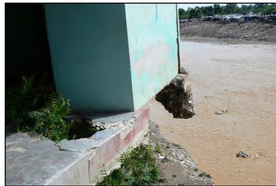
写真 - 11 : 洪水により護岸（床下）が浸食された建物
