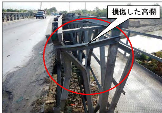
写真 - 21 : 車両による衝突で損傷した高欄
