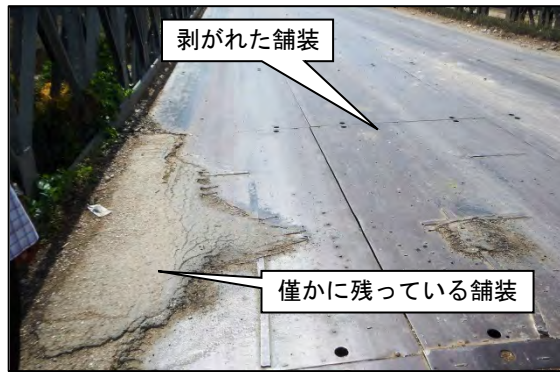
写真 - 19 : 剥がれたアスファルト舗装
