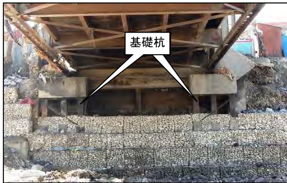
写真 - 3 : 洪水による浸食で露出した基礎杭 (A1)
