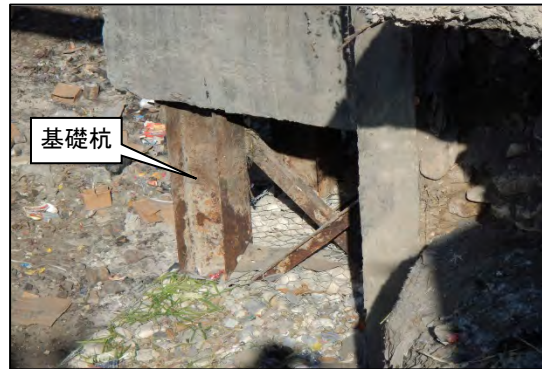
写真 - 4 : 洪水による浸食で露出した基礎杭 (A1)
