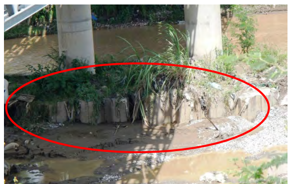
写真 - 24 : 洗掘されている基礎
