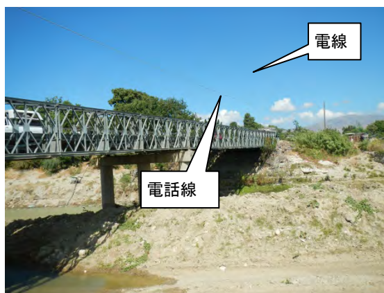
渡河部(上流側)にあるユーティリティー
