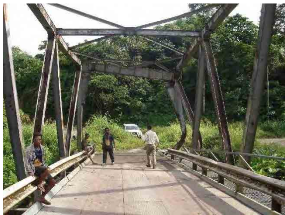
4. 既設橋破損箇所
