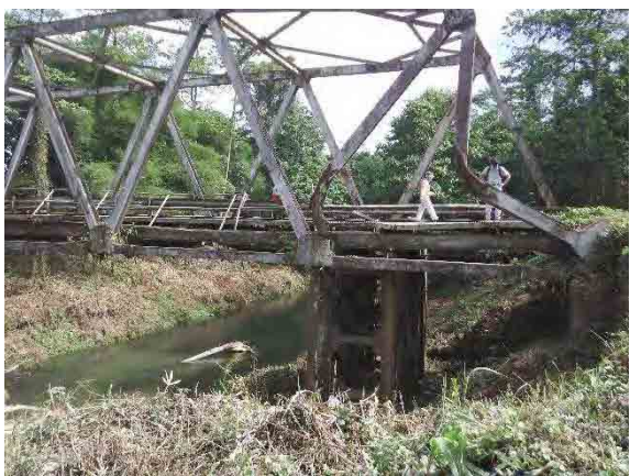
5. 既設橋破損箇所 側面
