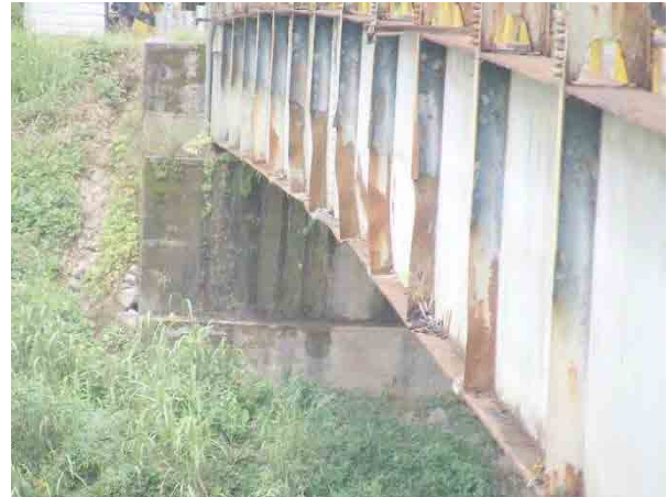
写真 2.1.2 補剛桁損傷部
