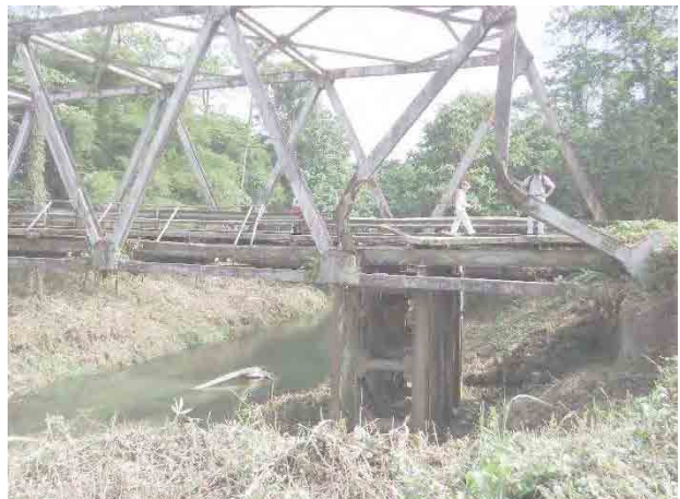
写真 2.1.9 損傷した橋門溝と仮支柱
