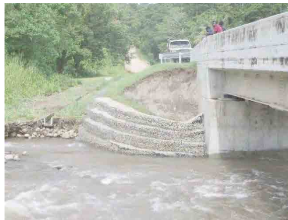
写真 2.1.12 Warakapis 橋の被災状況
