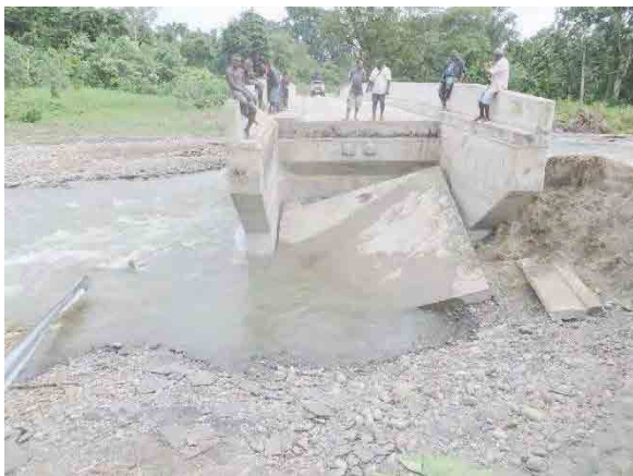
写真 2.1.11 Rotaovei 橋の被災状況
