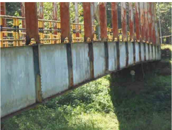
5. 既設橋桁 流木と衝突の痕跡有り
