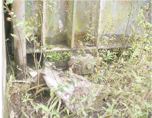
写真 2.1.7 支承部の状況（清掃が必要）
