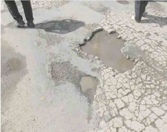
写真 2.1.6 コンクリート庄版の損傷状況
