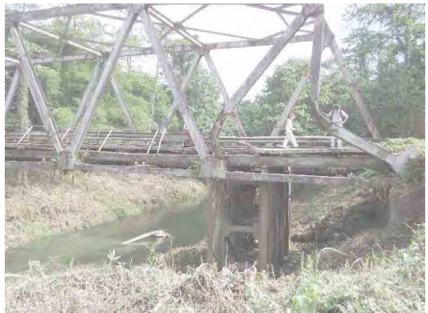
写真 2.1.9 損傷した橋門溝と仮支柱
