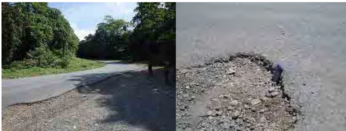
写真 3.2.2 舗装端部の破損状況
