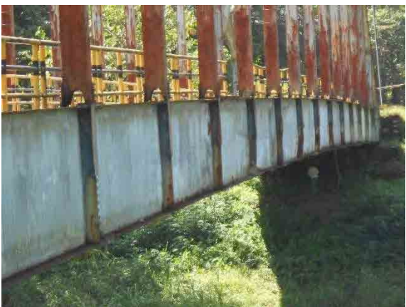
5. 既設橋桁 流木と衝突の痕跡有り
