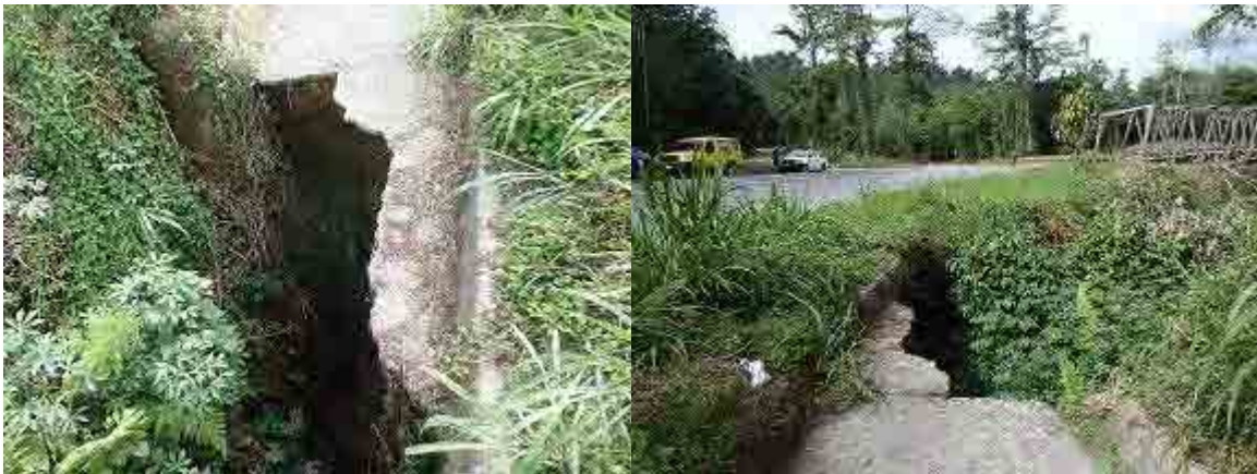
写真 3.2.1 水路破損による路側の浸食崩落
