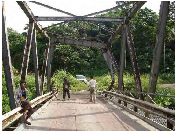
4. 既設橋破損箇所
