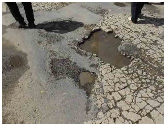
4. RC床版の状況 貫通クラック多数あり
