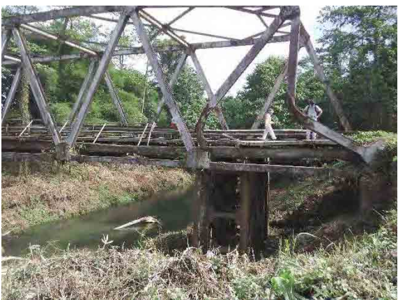
5. 既設橋破損箇所 側面
