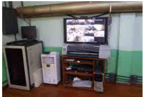
場内監視モニター
