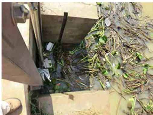
写真 4: TSC1、2、及び 3 でモデル圃場となった灌漑区内の水路の清掃は行き届いていない。写真の 1 次水路は掃除されたことはないが、たまっているゴミも水門を開ければ流れ去るので問題ないとのことであった。
