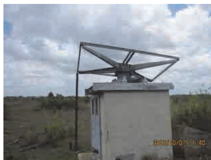
写真4 盗難に遭った太陽光パネル
