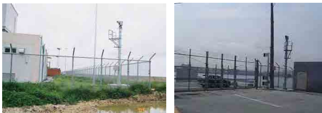
図 I.1.4-2 CCTVカメラ (参考)
