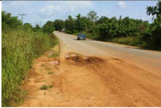
アシンプラシアコ近傍での舗装破損状況
