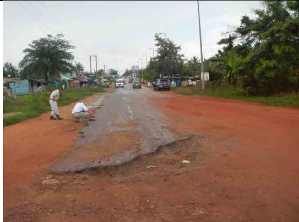
アシンプォス市街地での全面的な路盤の露出状況
