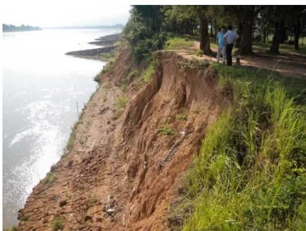
ボリカムサイ県河岸侵食状況 1 (2010年12月)
