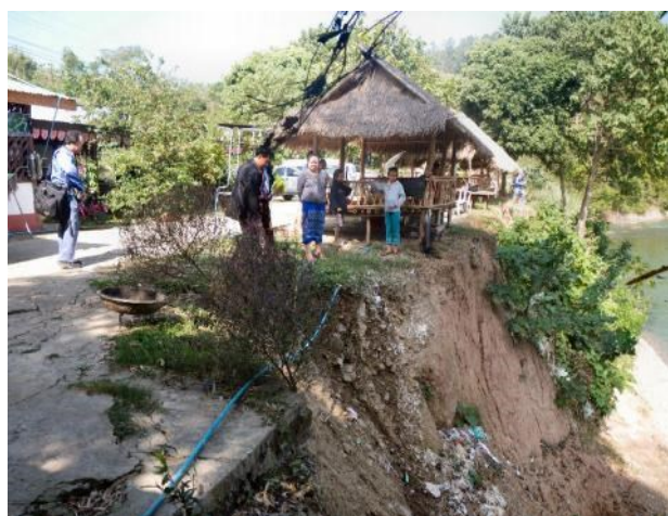
ルアンパバン県河岸侵食状況 2 (2010年12月)
