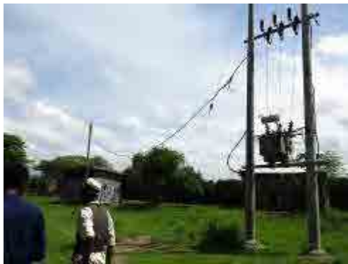
既存施設（商用電力）
