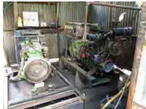
既存施設（発電機）
