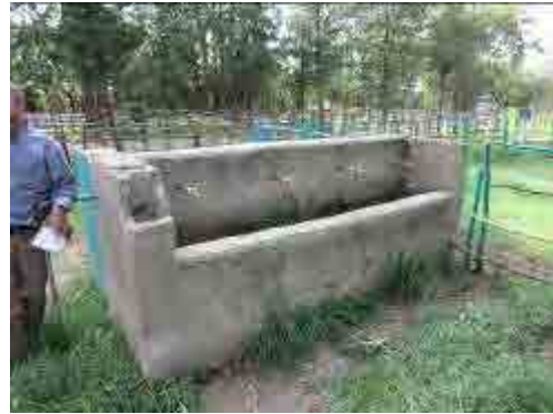
既存施設（公共水栓）
