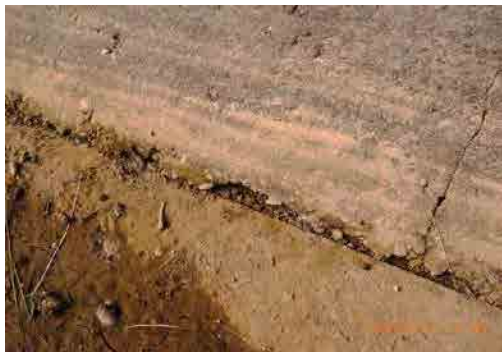
写真-6：NADC 親魚/中間育成池、漏水原因のコンクリート亀裂部分
