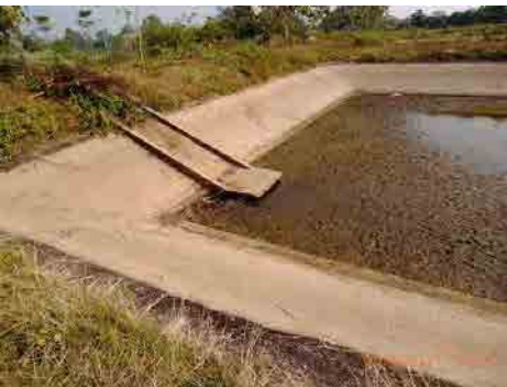
写真-5：NADC 漏水のため使用できない親魚/中間育成池
