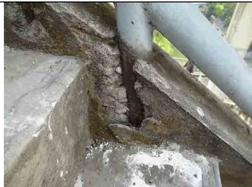
屋外階段 手すり部分の腐食とコンクリートの剥離
