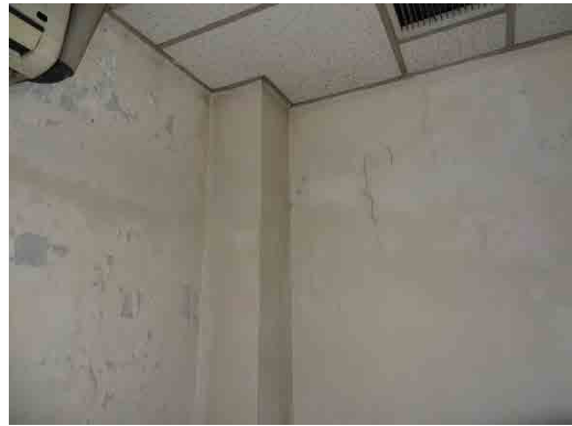
観測室 壁隅角部のクラック
