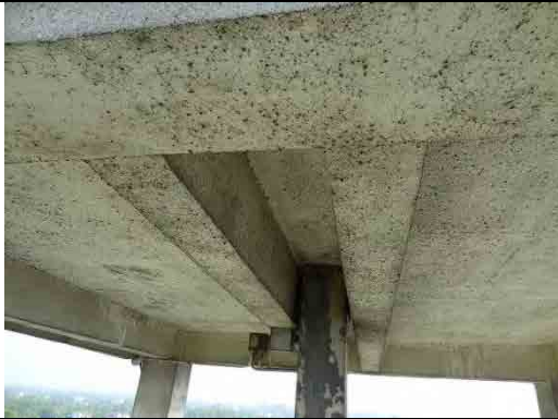
最上階ケーブルダクトと レーダーペデスタル受け梁
