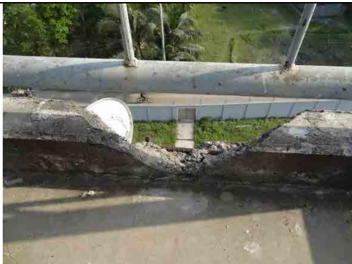
2階屋上 パラペット部分のコンクリートの滑落
