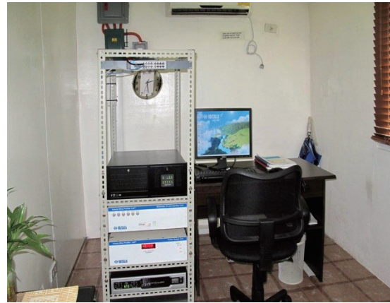
左記機器のデータ表示装置
