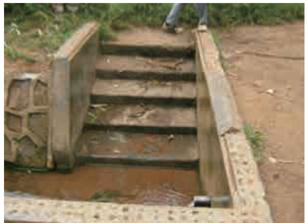
飲料水確保のための湧水利用施設 (2013年7月25日)
