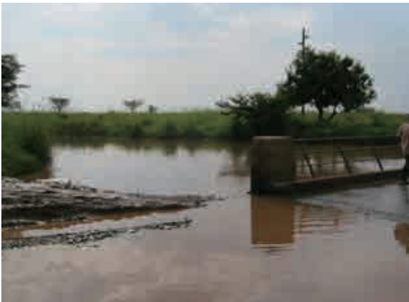
土砂の堆積により越流しているゲンゲ川 (2013年7月17日)
