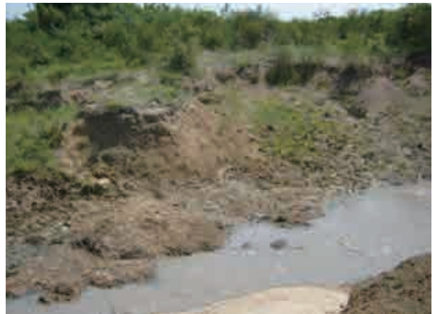
オミリオ貯水池の崩壊した洪水吐 (2013年7月22日)
