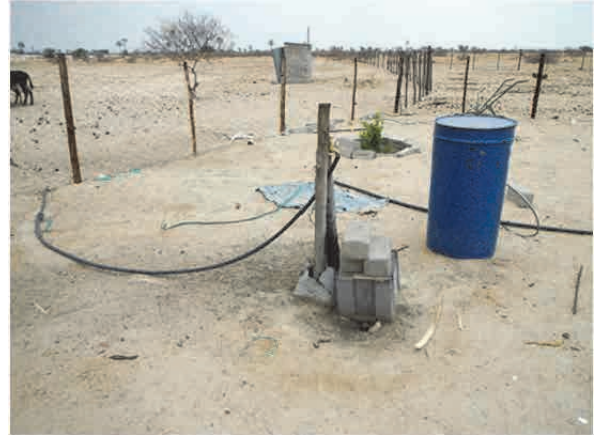
農家に引かれた水道
